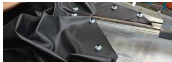
4. Details einarbeiten Eckstücke, Oberlichtkuppeln und andere Dachdurchdringungen werden in die Dachhaut integriert.
